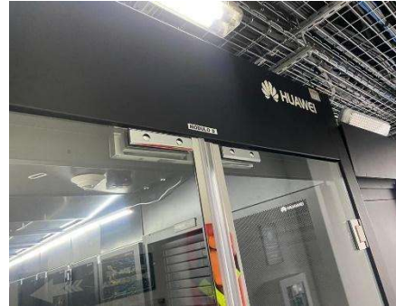
Ilustración 4. Acceso a Rack – Módulo D
