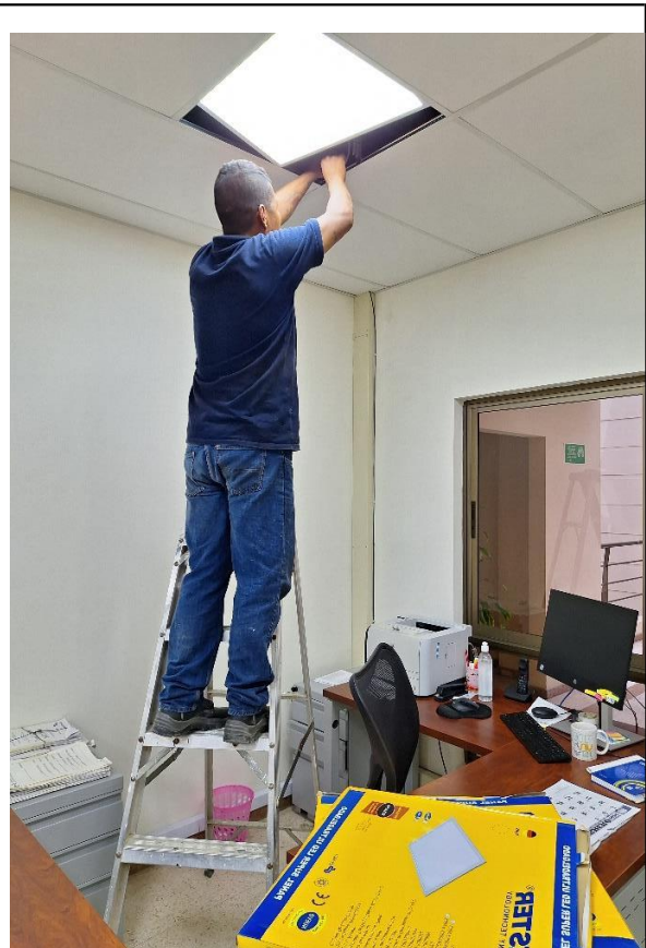
Cambio de luminaria a algunos despachos judiciales palacio de justicia.
